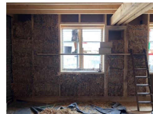
Dans le projet KAPER, la paille a été utilisée pour isoler l'extension. Compte tenu de la structure moins complexe du mur, son épaisseur ne diffère pas beaucoup de celle d'un mur extérieur conventionnel. © Hé Architectuur
