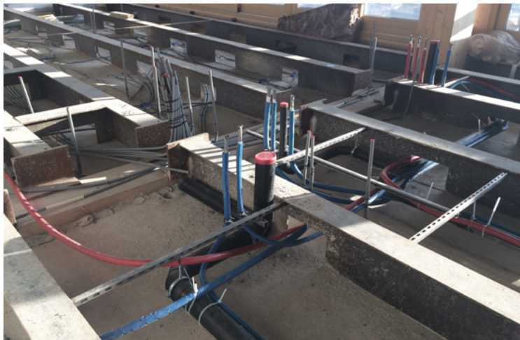
En appliquant des planchers slimline dans le projet PATCH22, les techniques peuvent facilement suivre d'autres itinéraires ou être étendues ultérieurement. © Luuk Kramer
